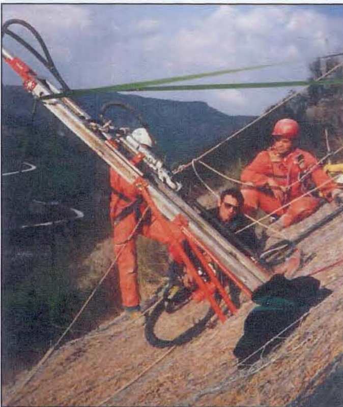
Foto 8 – Particolare realizzazione micropali con sonda appositamente costruita e calata con funi dalla sommità della scarpata, evitando l'impattante e problematica apertura di una pista d'accesso. (Con giacca scura il Dr. Gennari che ha seguito personalmente la D.L.)
