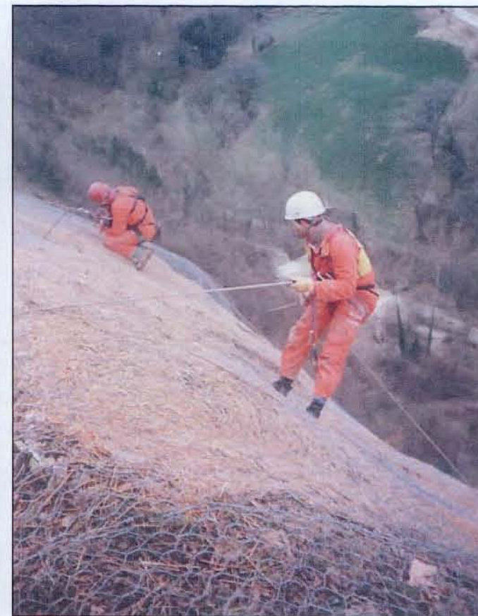
Foto 6 – Lavori in parete: bloccaggio delle reti sopra le biostuoie. (Al piede del versante il T. Mutino)
