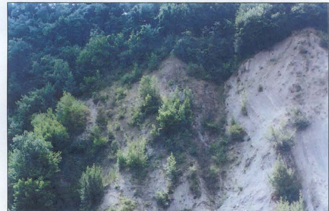
Foto 3 - Luglio 2000: Particolare dell'area "A" sottostante il muro in c.a. completamente coperto dalla vegetazione. Si noti la differenza tra l'area completamente inerbita e consolidata e la zona immediatamente a destra, dove non sono stati effettuati gli interventi, in cui l'azione erosiva e di denudamento è ancora in atto.
