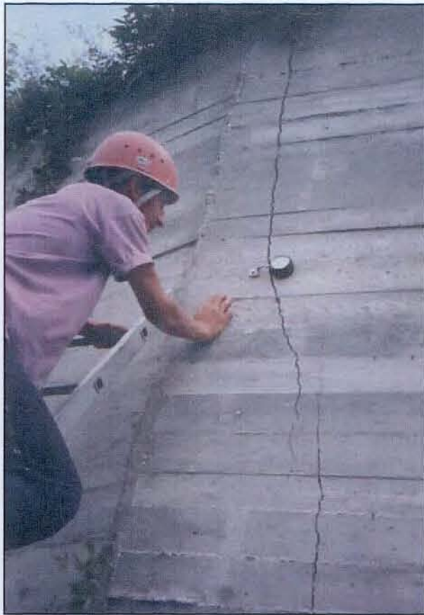
Foto 4 – Lesione sul muro in c.a. preesistente, interessato da scalzamento al piede.
